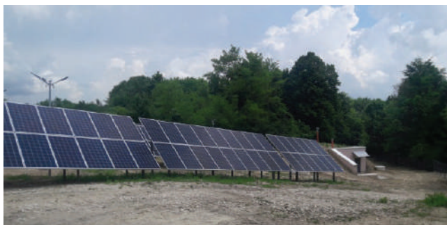
Figura 17. Sistem fotovoltaic pentru pomparea apei în s. Milești 18
